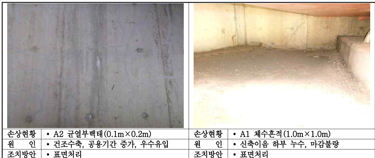
【사진 18.3.9】 교대 손상현황
